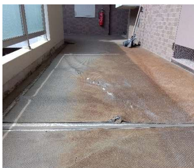
劣化破損した塩ビシート床
