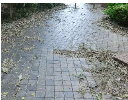
タイルの破損と散乱した落ち葉
